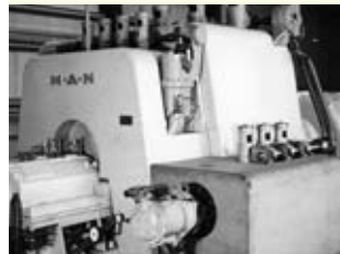
22.1.1971 – eine Turbine im Heizkraftwerk Römerbrücke
