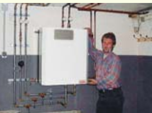
Eine Hausanschlussanlage auf dem Eschberg: platzsparend und modern
